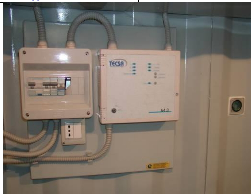
Dettaglio interno quadro elettrico e centralina allarme
