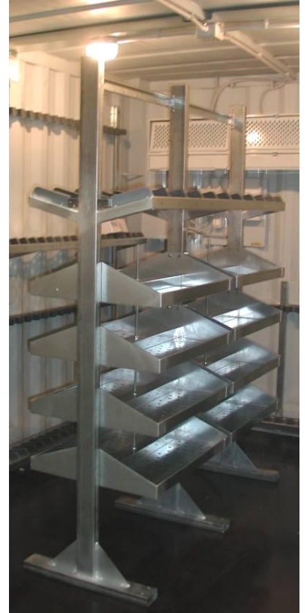
Modalità a doppio fronte, in linea con uguali moduli, posta in posizione libera da pareti, fissata entro un modulo armeria mobile
