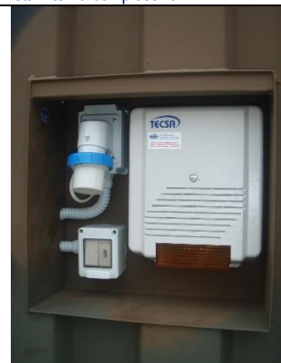
Dettaglio esterno con: derivazione elettrica, inseritore allarme - accensione luce interna e sirena con lampeggiante
