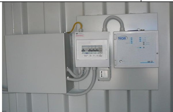
Dettaglio interno quadro elettrico e centralina allarme
